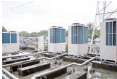
ビル用マルチエアコンの室外機ユニット
