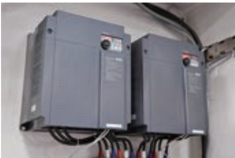
冷温水ポンプの制御のために設置されたインバーターは、省エネに貢献
