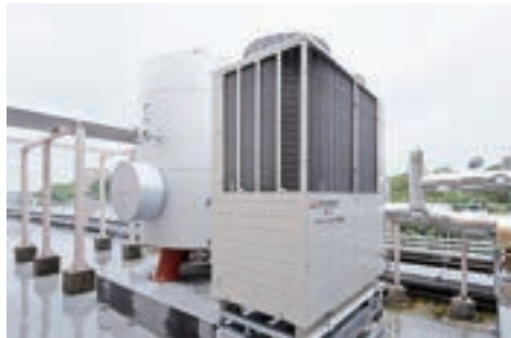
エコキュートのヒートポンプユニットと貯湯タンク
