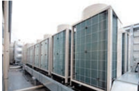
ヒートポンプ式空調機
