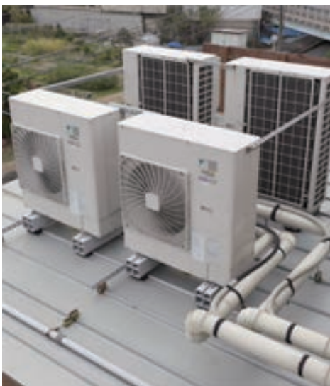
インバータータイプのビル用マルチエアコンを採用
