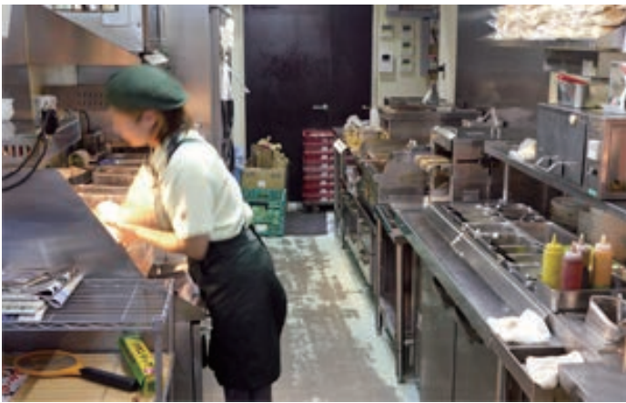
火の元がないため安心という、電化厨房。涼しく、快適な作業環境へと変化した
