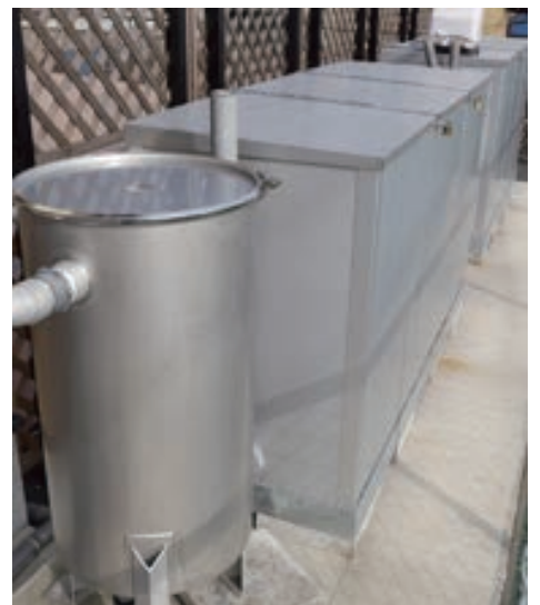
雨水の貯水タンクも設置し、トイレや散水などに再利用
