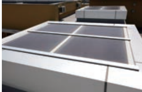
トップライトはガラスと一体型の太陽光発電パネルを採用。室内からはガラスにしか見えないデザイン
