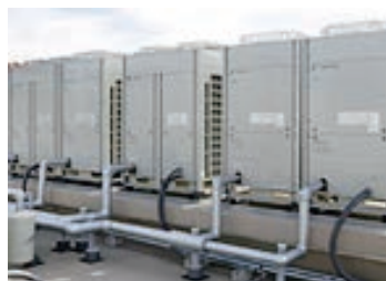
E 空調(ビル用マルチエアコン)
